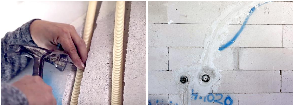
Kuva 8. Sähköputket kiinnitetään roilon pohjaan kuumasinkityllä naulalla ja roilot täytetään ennen tasoitusta vähän kutistuvalla laastilla, esim. sisätiloissa kipsilaastilla.
